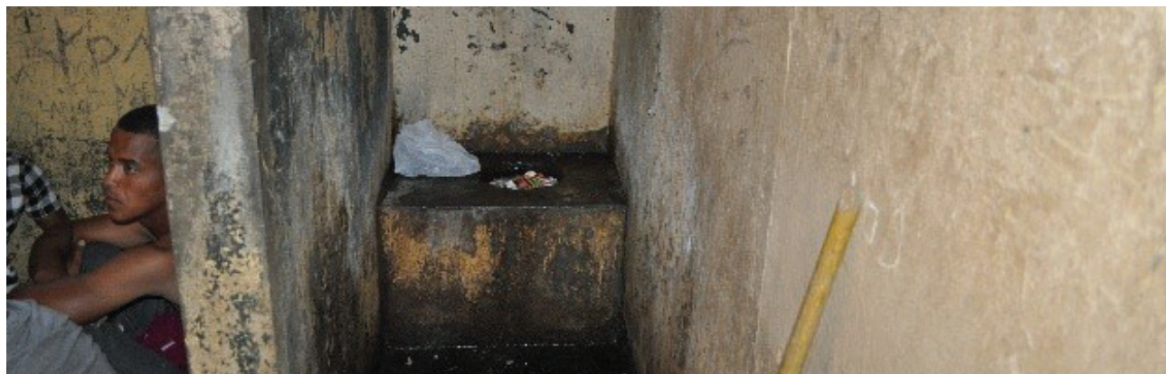
Destacamento de La Vega donde se observan las condiciones de los baños
